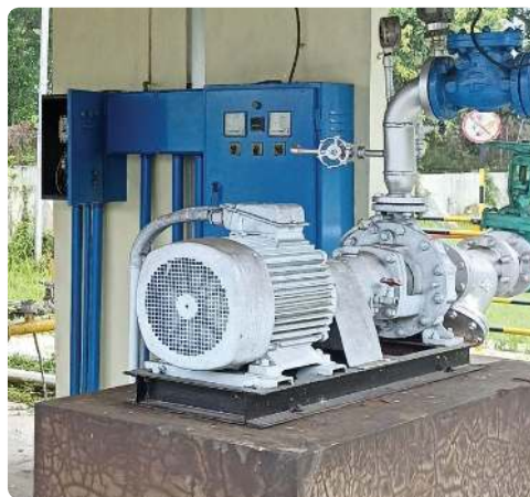
Gambar 7.31 Pompa Sumber: Siska (2023)
