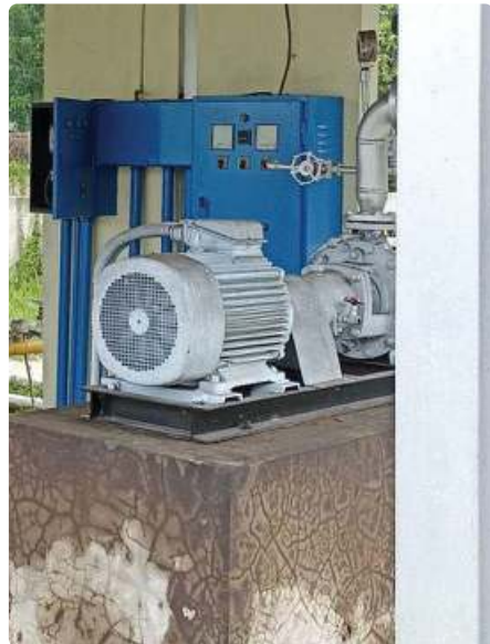
Gambar 8.2 Pompa Sumber: Siska (2023)
