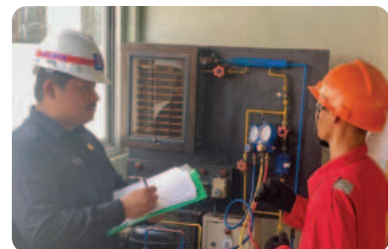
Gambar 3.12 Teknisi sistem refrigerasi sumber: Dudi Rachadi/Kemendikbudristek (2024)
