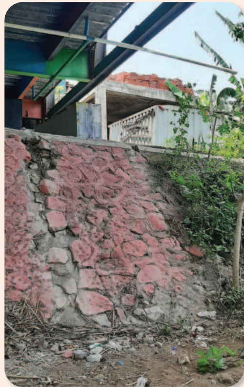
Gambar 2.3 Kegagalan Konstruksi Irigasi
