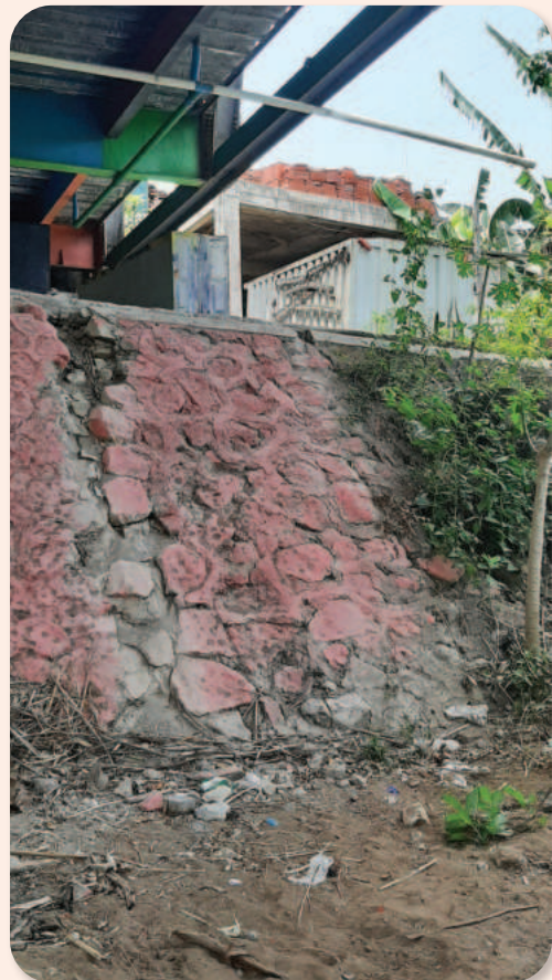
Gambar 2.9 Kegagalan Konstruksi Irigasi
