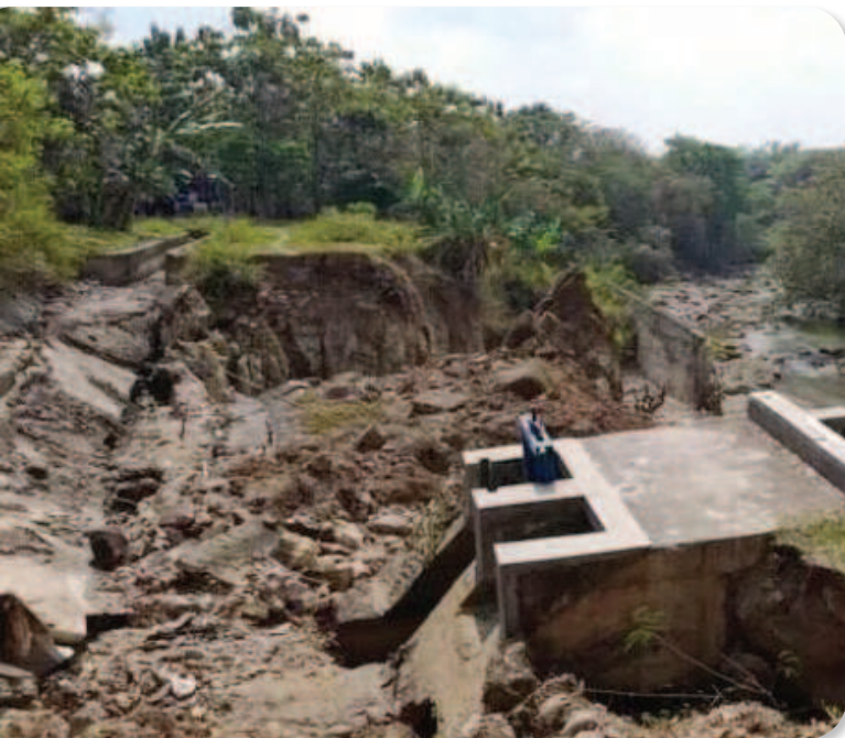
Gambar 2.5 Tanggul dan Saluran Irigasi Runtuh di Sragen
