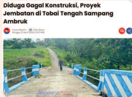
Gambar 5.8 Berita Proyek Jembatan Ambruk
