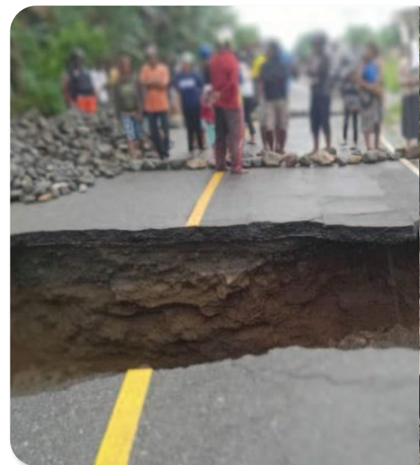
Gambar 2.4 Jalan Amblas di Maluku
