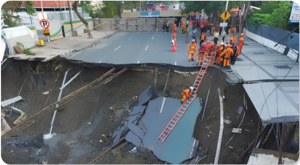
Gambar 2.8 Kegagalan Konstruksi Jalan
