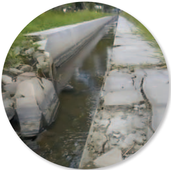
Gambar 4.2 Proyek Saluran Irigasi di Jombang Rusak
