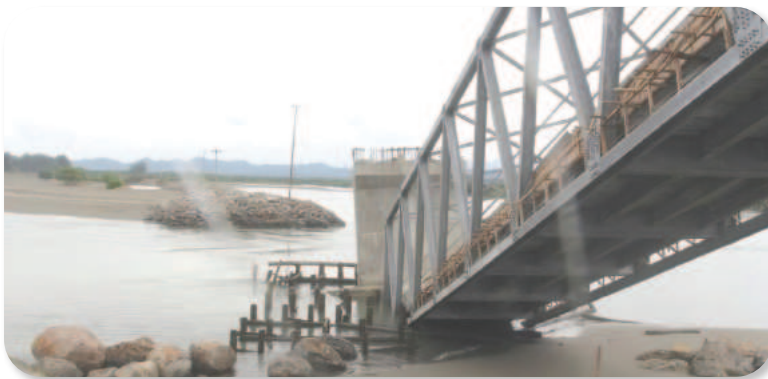
Gambar 2.2 Jembatan di Pidie Aceh Roboh
