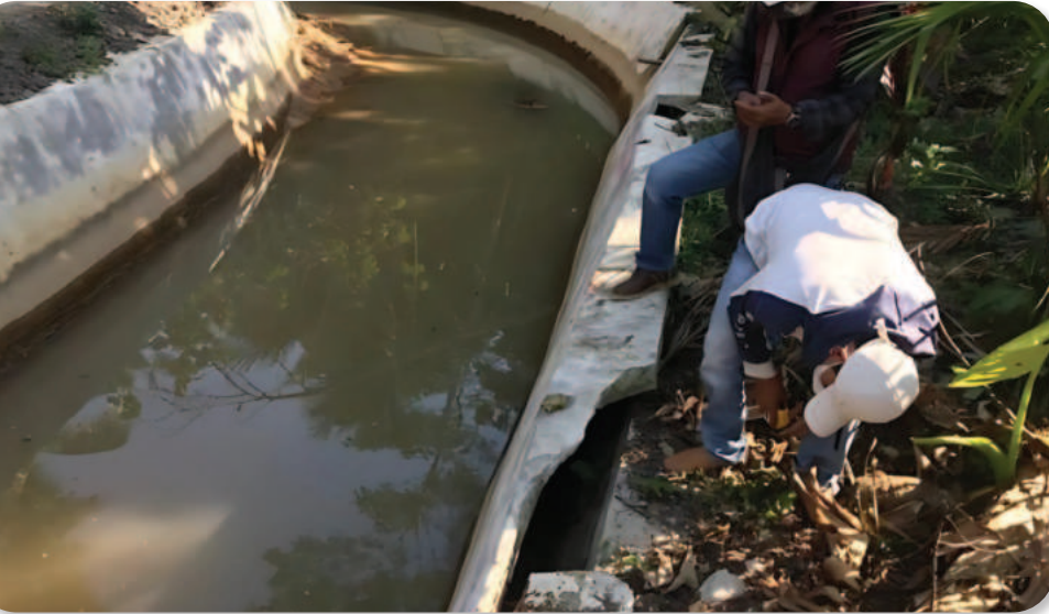
Gambar 4.1 Irigasi Bantarheulang Rusak
