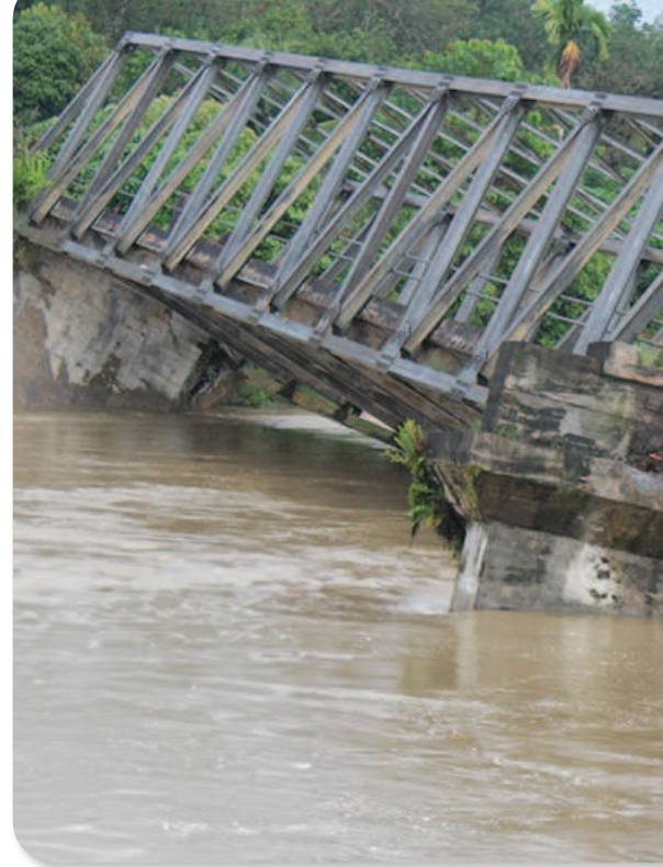
Gambar 2.1 Konstruksi Jembatan Ulee Raket Roboh di Aceh
