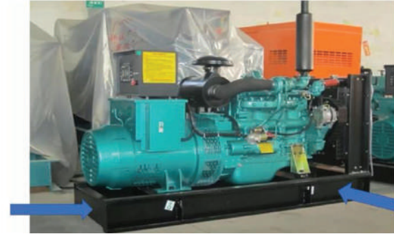
Gambar 4.20 Generator Set dengan Frame Base/Dudukan Mesin
