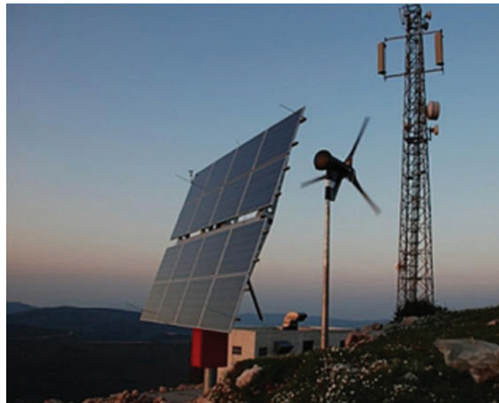
Gambar 4.2 Off-Grid Hybrid PV-Wind-Diesel untuk Persediaan Listrik pada Sebuah Base Station Sumber: Ikram (2022)
