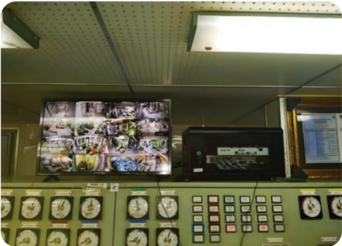
Gambar 4.14 Monitor pengawas CCTV di ruang kontrol.
