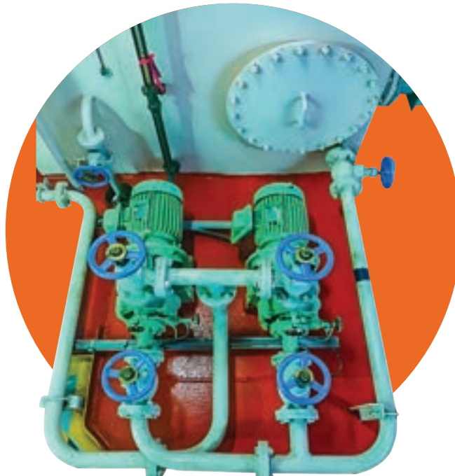
Gambar 4.3 Motor listrik pompa air tawar di kapal.
